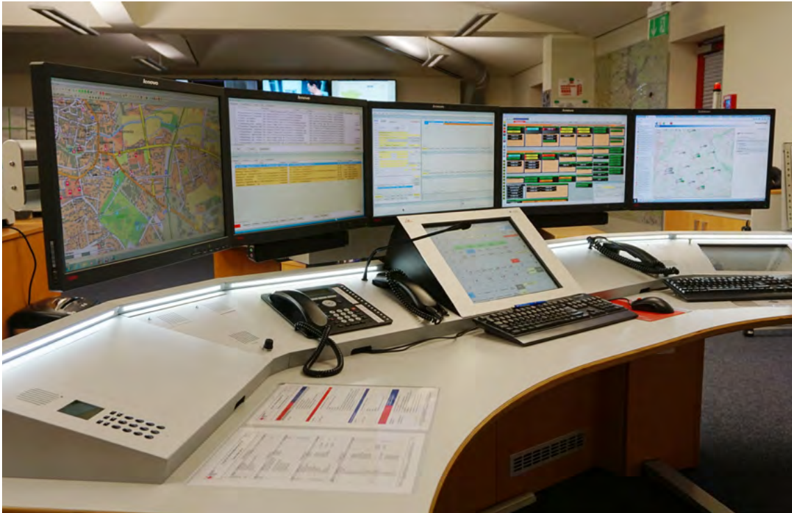
Abb. 1: Typische Technik für den Arbeitsplatz in einer Leitstelle
